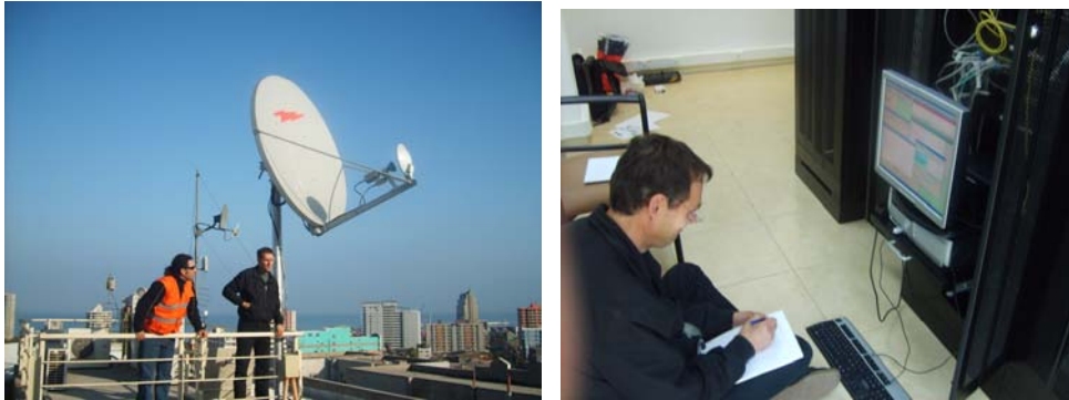
Antena Principal o HUB, y unidad de monitoreo ubicados en el CDEC-SING
